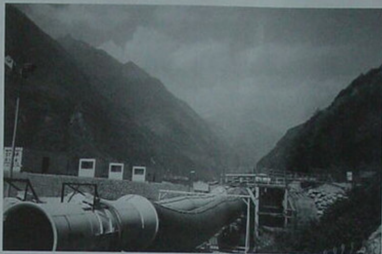
Un particolare del cantiere della Galleria del San Gottardo (foto Giordano Ciapparelli)
